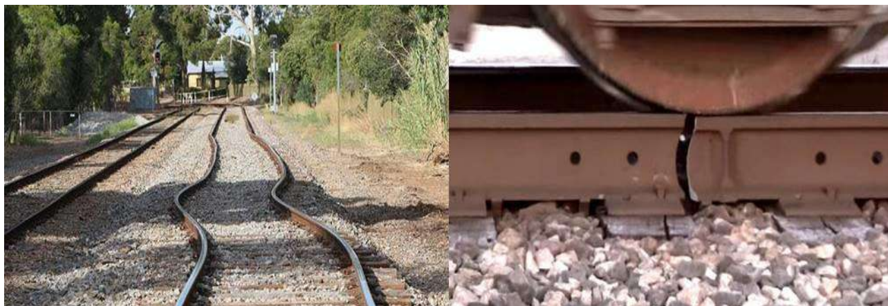
Slika 1.3 Izvijanje koloseka (levo) [3] i formiranje zazora pri pucanju šine (desno) [4]
